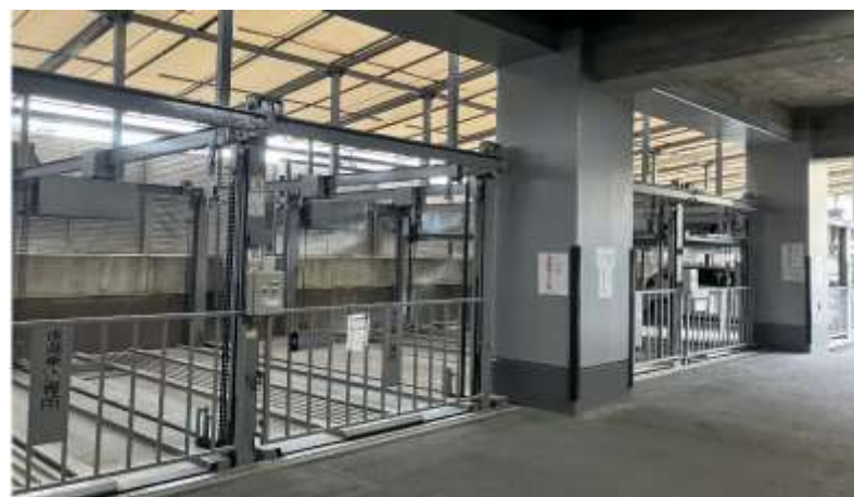
機械式駐車場
