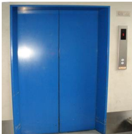
■ 貨物用エレベーター
