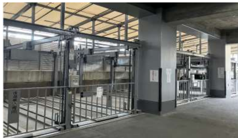
機械式駐車場
